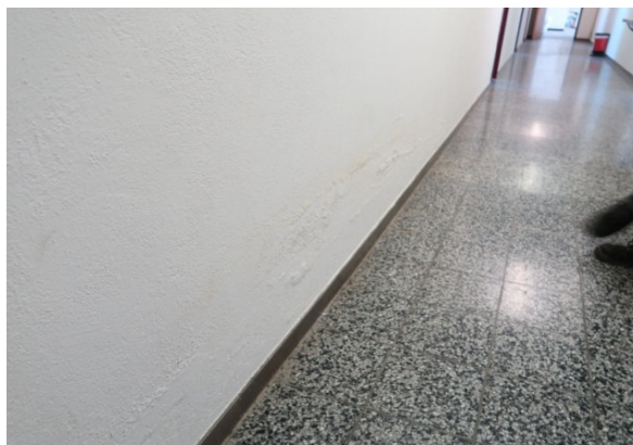
Feuchtschäden an Aussenseite Duschewand
